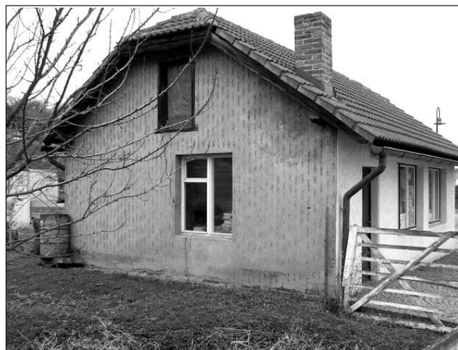
Trhlina ve štítové zdi.
